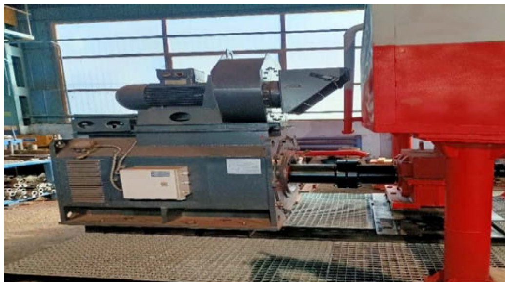
Fig. 2.2. b Ansamblu instalatie de cimentare – motor electric asincron
