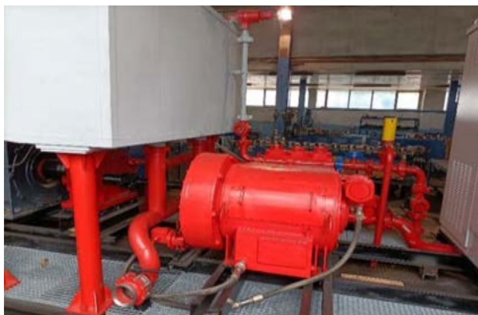
Fig. 2.2. f Ansamblu instalatie de cimentare- pompa triplex cu plungere
