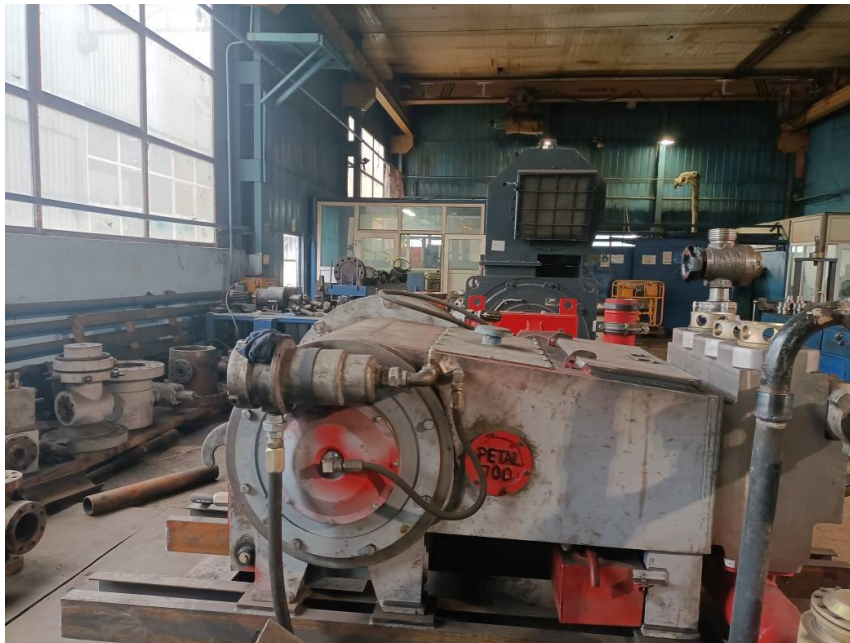
Fig. 1.11. g Ansamblu instalatie de cimentare- pompa triplex cu plungere
