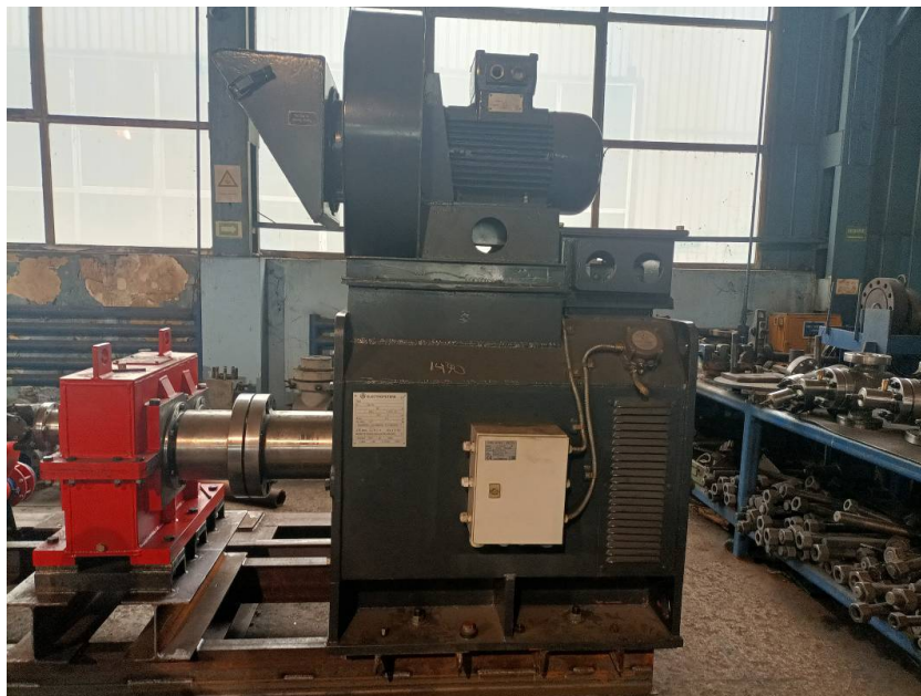
Fig. 1.11. e Ansamblu instalatie de cimentare – elemente de transmitere flux putere
